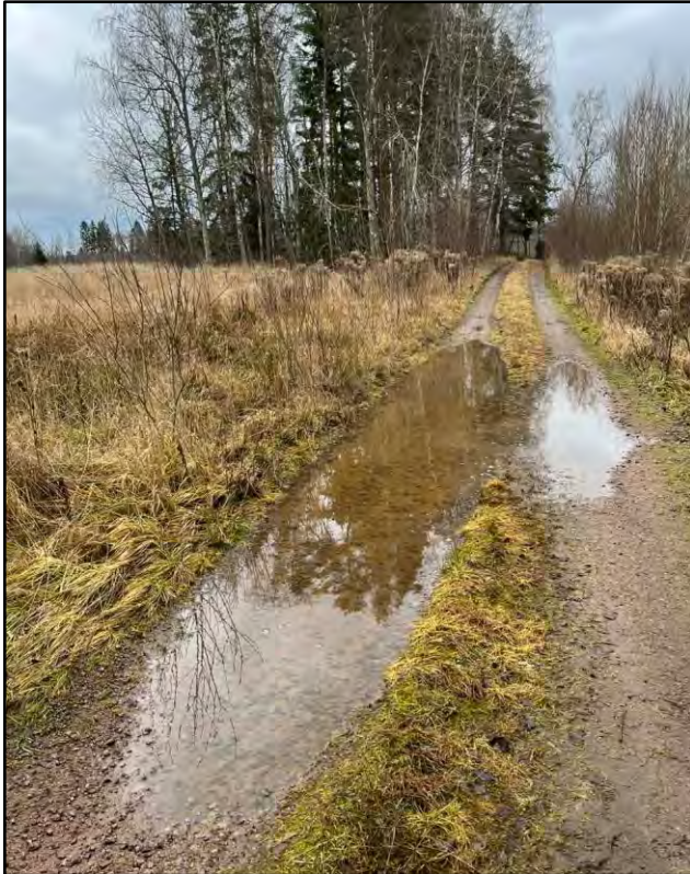
Figur 9. Vattenansamling i lågpunkt på befintlig grusväg
